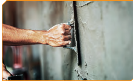
Çimentonun donması, betonlaşma
