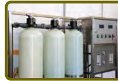
Su arıtma tesisi
